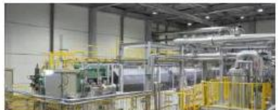
10MW 電解装置 出典：旭化成
